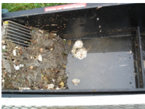
Entrée de station colmatée
